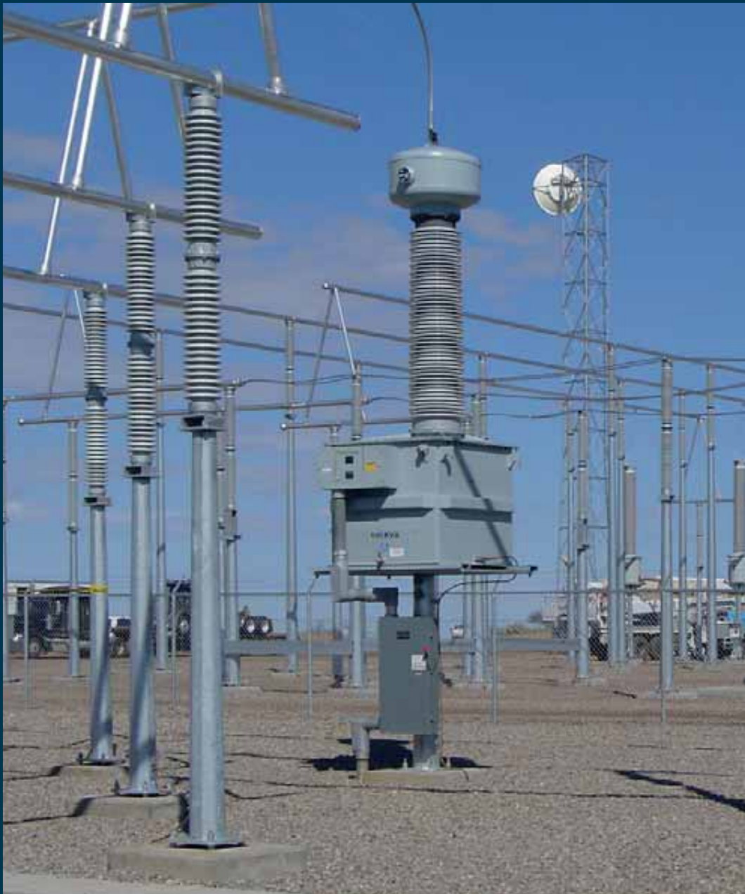
› 245 kV Przekładnik dla potrzeb własnych podstacji, model UTP. Coyote Switch (USA).
