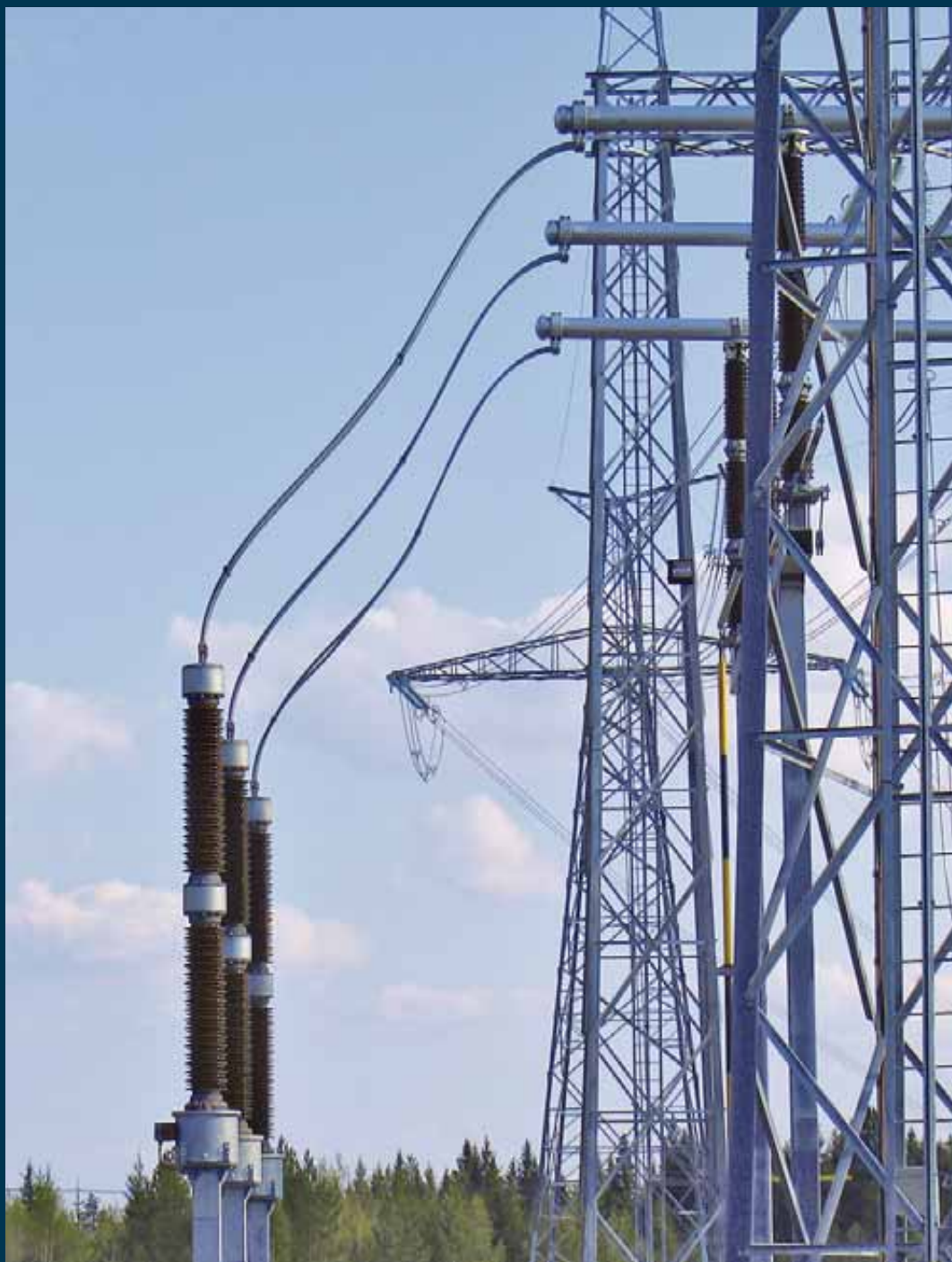
› 420 kV Pojemnościowe przekładniki napięciowe. Fingrid, Visulahti (Finlandia).
