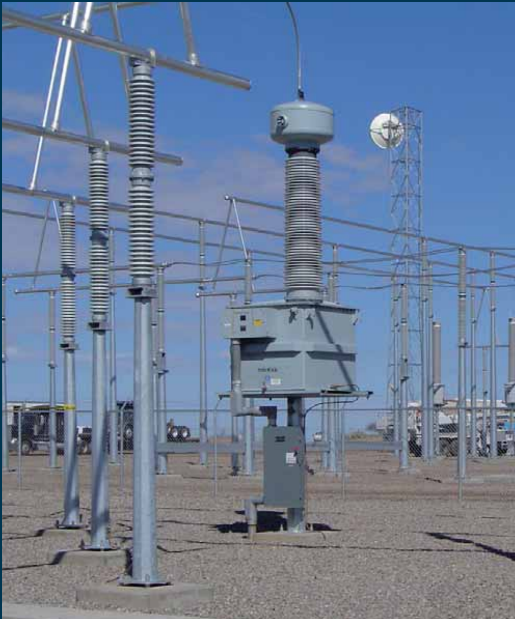
› Transformateur pour services propres de la sous-station modèle UTP de 245 kV. Coyote Switch (États-Unis).
