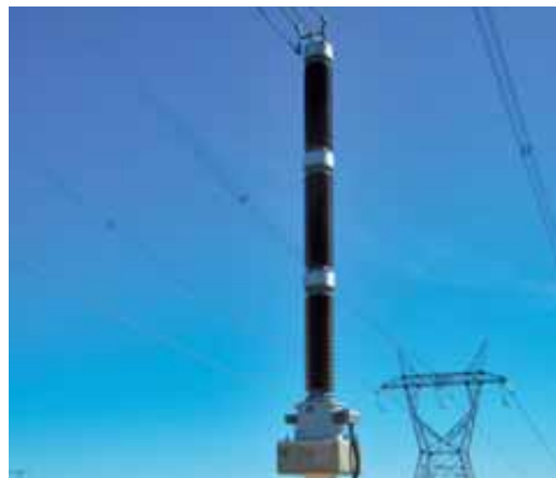
> Transformadores de potencial capacitivos de 245 kV. NEPCO (Jordânia).
