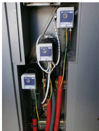
› Sensores de voltaje PLUGSENS Instalados en una celda de casquillo con restricciones de espacio
