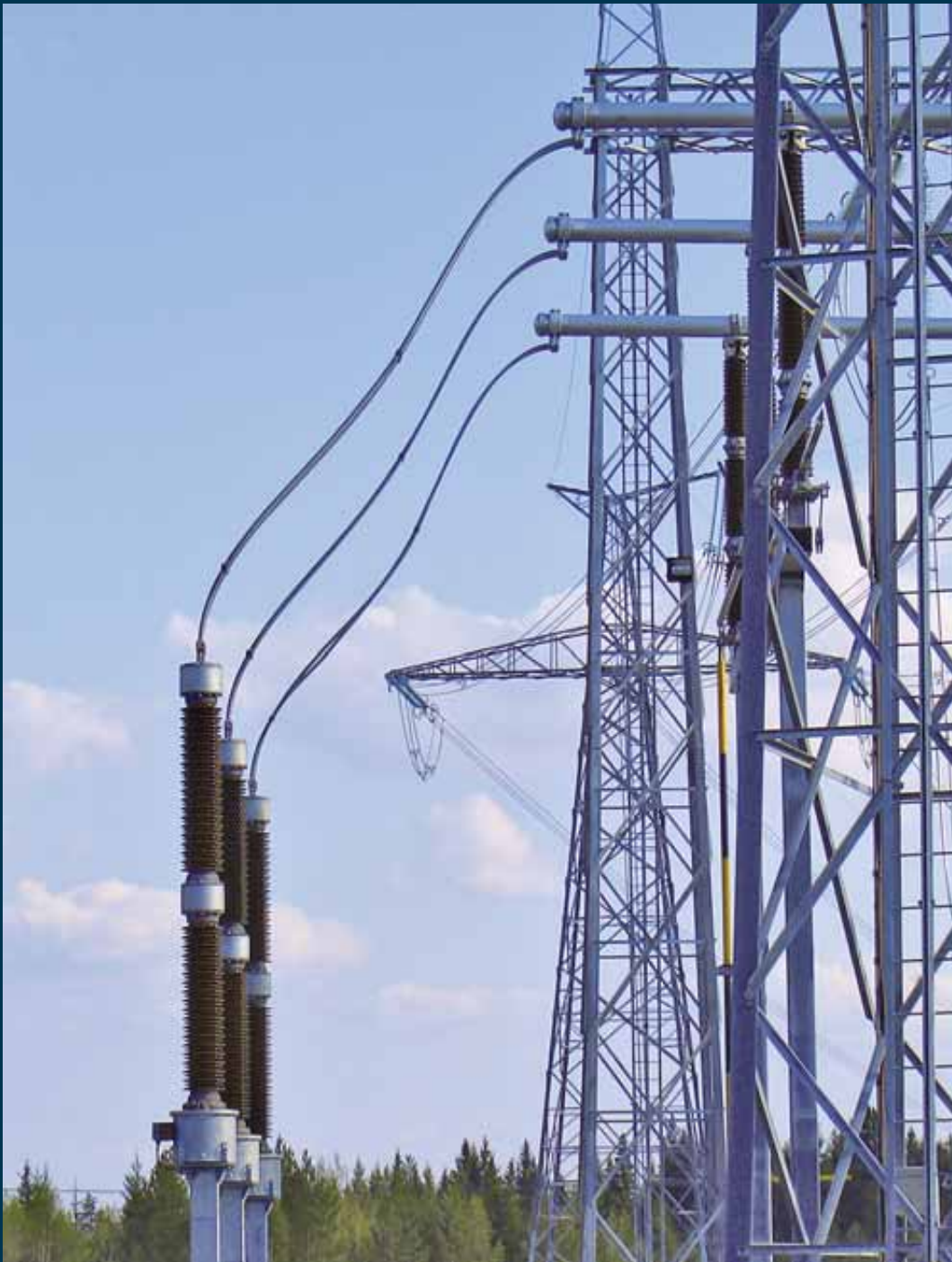
➤ Transformateurs capacitifs de tension de 420 kV, Fingrid, Visulahti (Finlande).
