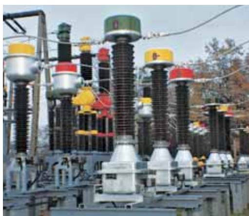
1. Transformateurs inductifs de tension de 123 kV (Bosnie).
