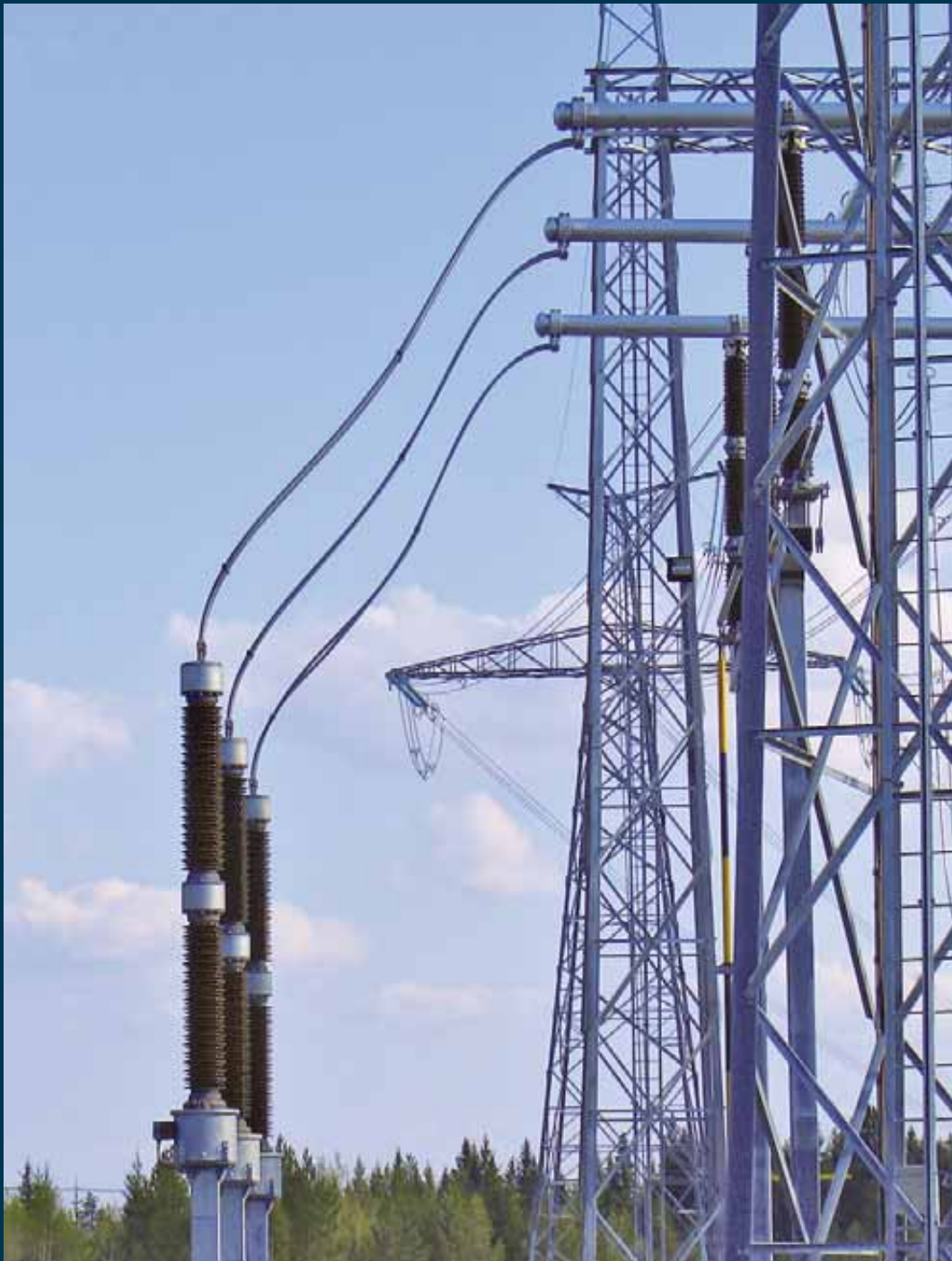
› Transformadores de tensión capacitivos de 420 kV. Fingrid, Visulahti (Finlandia).
