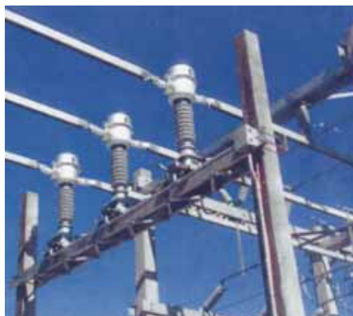
> Trasformatori combinati da 170 kV. Pechiney (Olanda).
