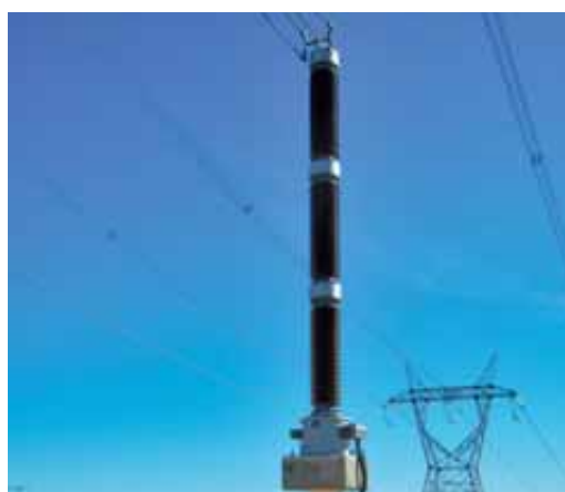
> Trasformatori di tensione capacitivi da 245 kV. NEPCO (Giordania).
