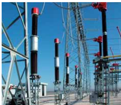
3. Trasformatori di tensione induttivi da 420 kV. Rede Eléctrica Nacional (Portogallo).
