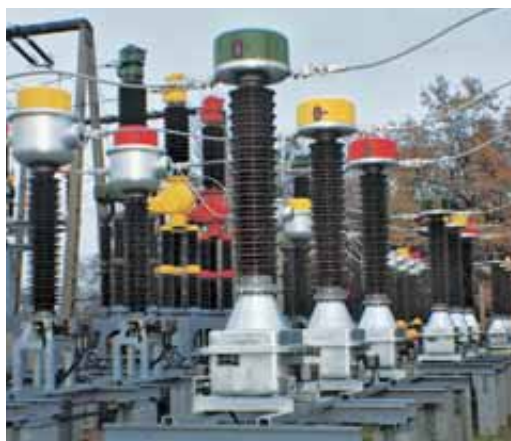
1. Trasformatori di tensione induttivi da 123 kV (Bosnia).
