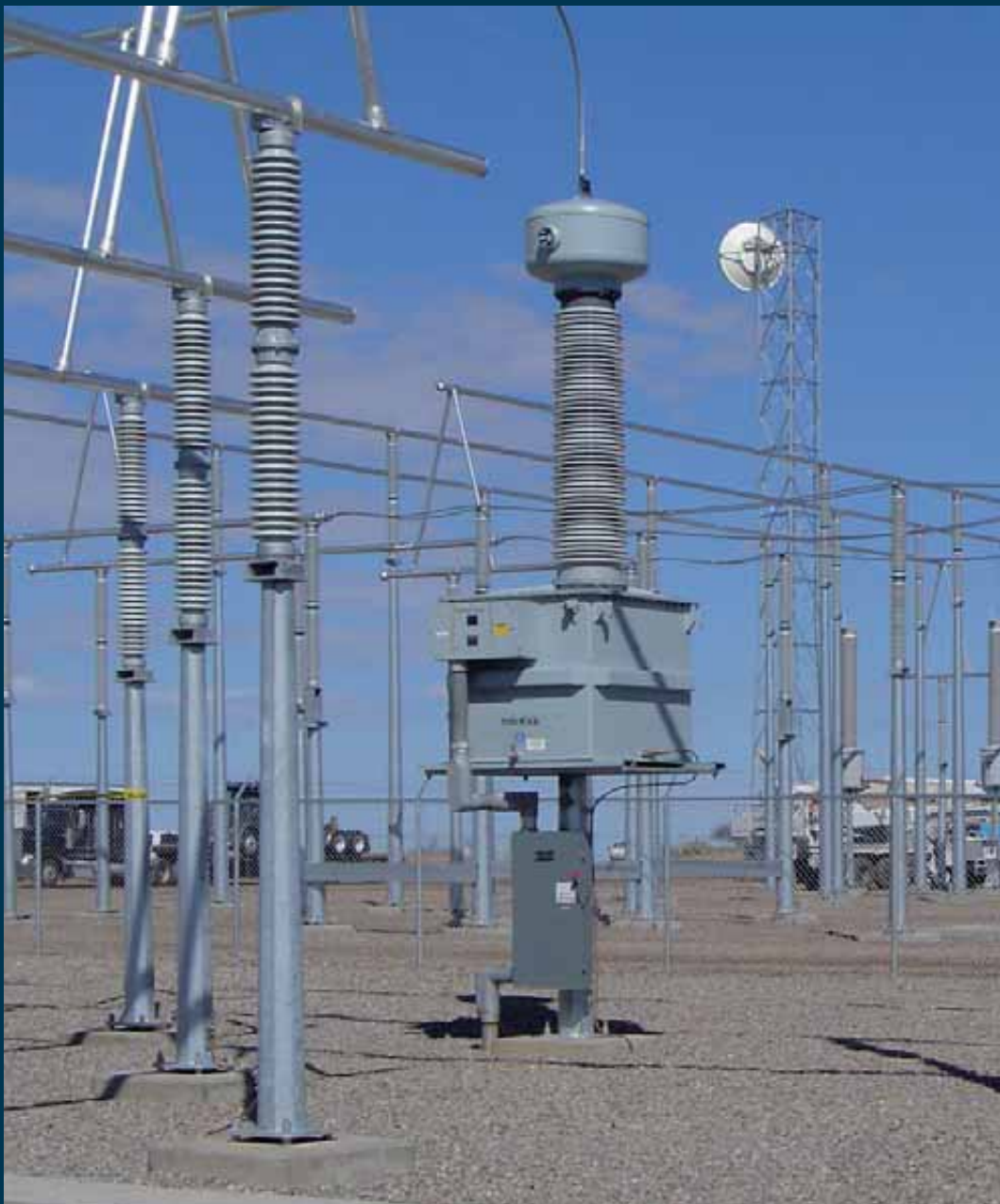
› Trasformatore per servizi propri della sottostazione modello UTP da 245 kV. Coyote Switch (Stati Uniti).
